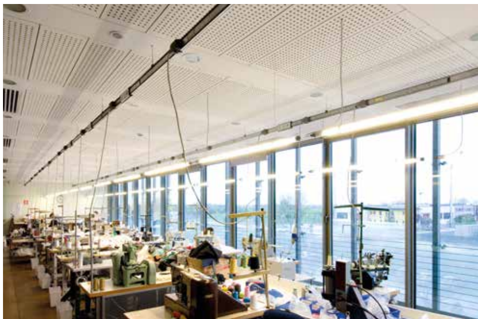
Шинопроводы для освещения и распределения электроэнергии малой мощности
